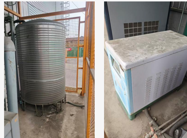
▲ 餘熱回收設備
